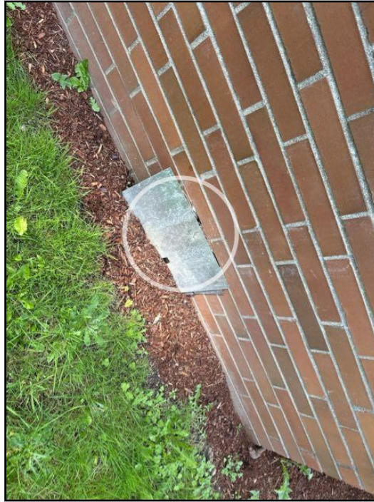
127. Cleanout door missing
